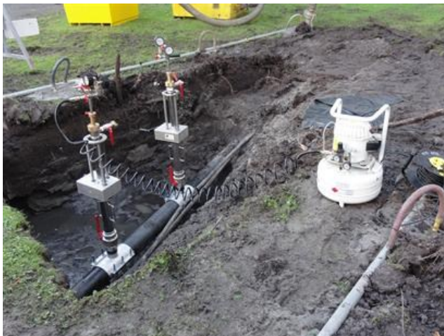
Met een compressor vullen we de gasblaas, dit doen we tot 8 bar om de leiding veilig af te sluiten.
