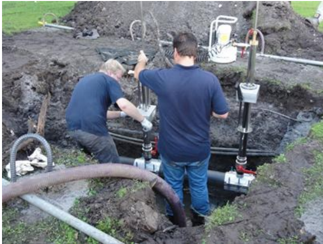
Als de kogelkraan open staat brengen we de gasblaas de leiding in, via een draaimechanisme op het opzetstuk.
